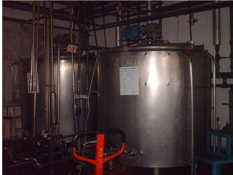
Fig. 5.2. Tanques de retención.
