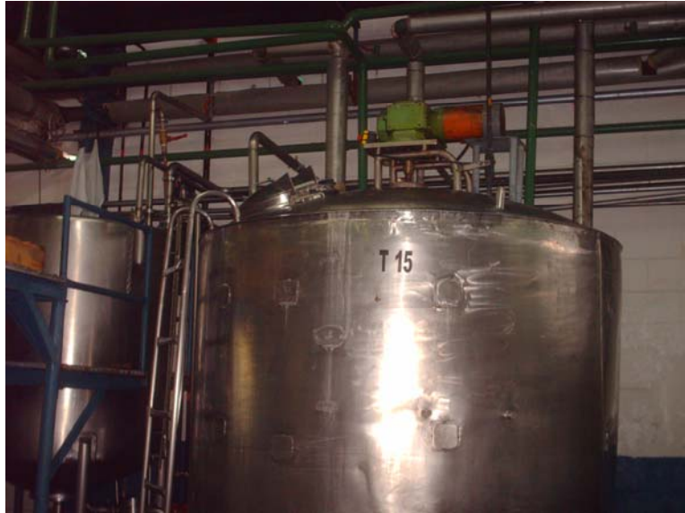
Fig. 5.1. Tanque de preparación del Área de Yogurt Firme.
