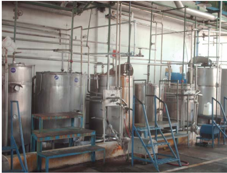
Fig. 3.29. Área de CIP.
