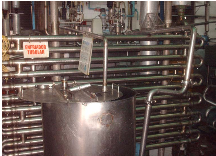
Fig. 3.7. Intercambiador de doble tubo para el enfriamiento de la crema.
