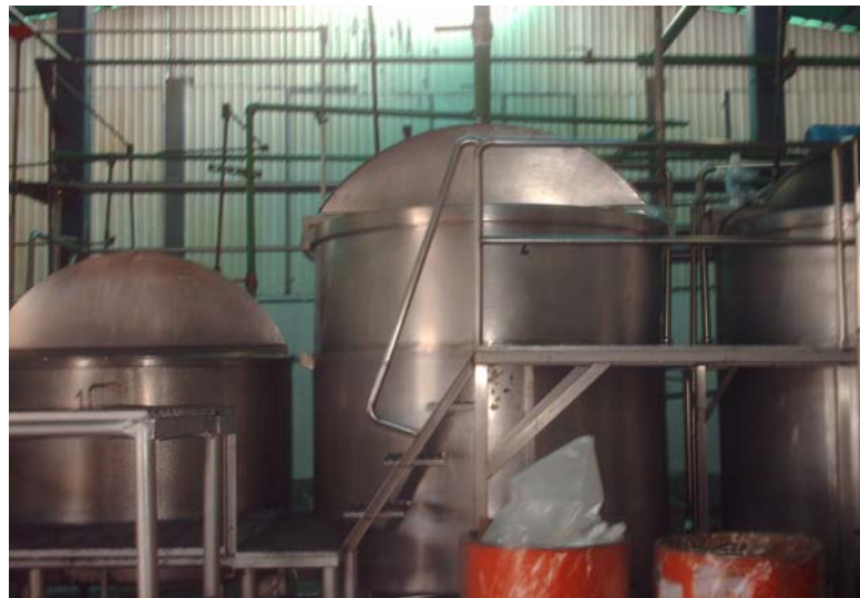
Fig. 3.2. Tanques de preparación de Jugos y Néctares.
