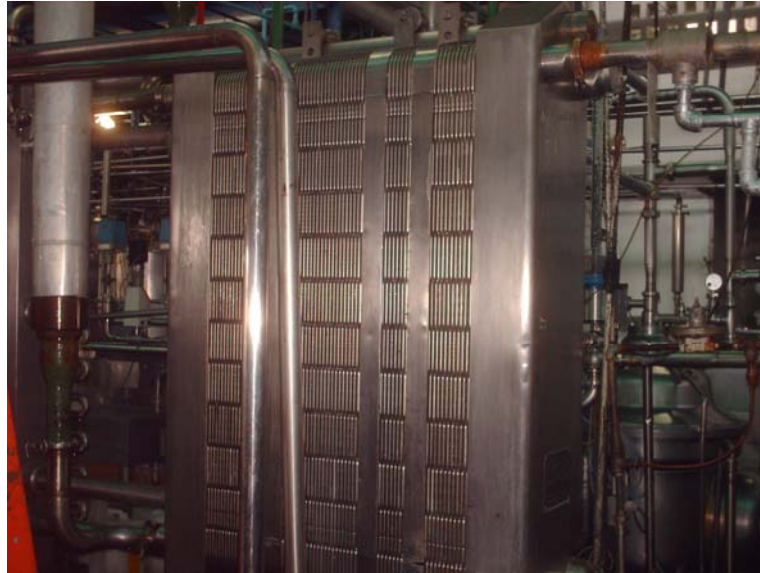
Fig. 3.8. Intercambiador de calor de placas del área de Pasteurización de Leche.
